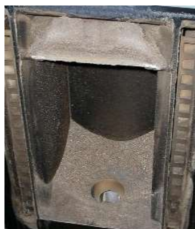
Fig. 98 : encrassement du foyer
