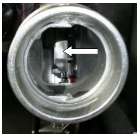
Fig. 144 : manchon d'air vicié avec ventilateur à hélices
