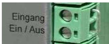
Fig. 51 : entrée Marche / Arrêt
