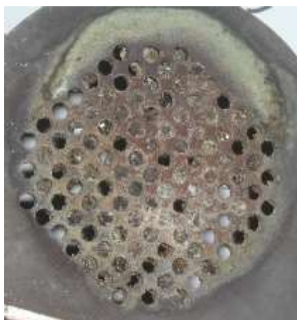
Fig. 123 : grille pivotante mal nettoyée
