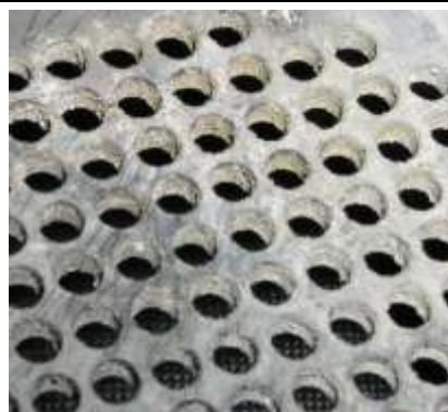
Fig. 124 : grille pivotante nettoyée correctement
