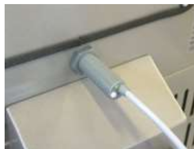
Fig. 63 : capteur de niveau installé
