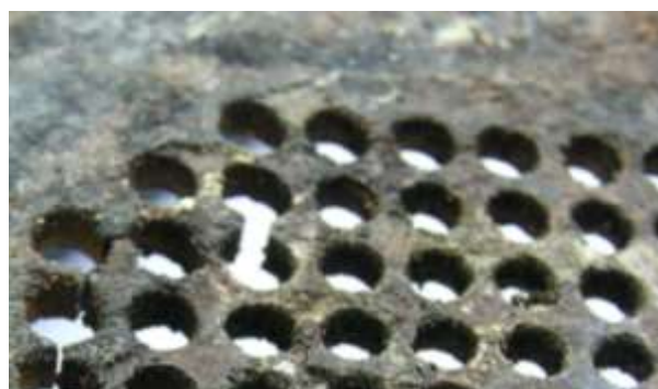
Fig. 126 : grille pivotante fissurée
