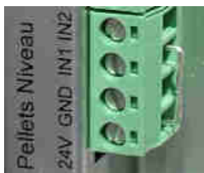
Fig. 60 : entrée niveau de pellets
