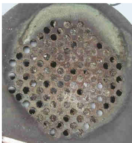
Fig. 123 : grille pivotante mal nettoyée
