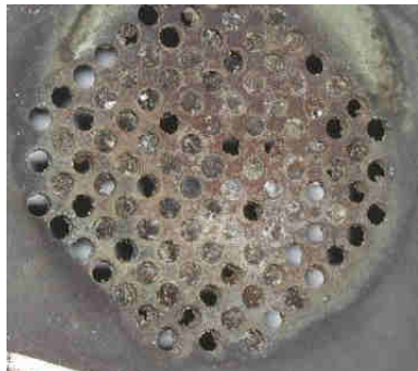
Fig. 100 : trous de la grille bouchés
