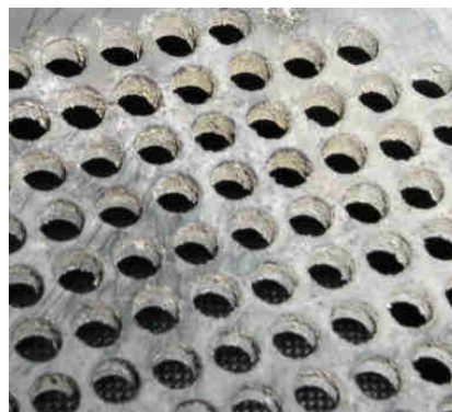
Fig. 124 : grille pivotante nettoyée correctement
