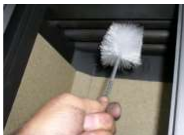
Fig. 39 : nettoyage de l'échangeur thermique
