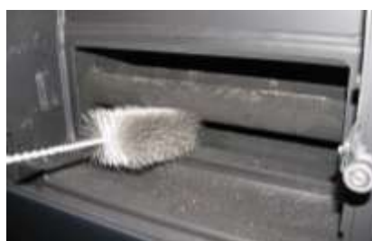
Fig. 37 : nettoyage de l'échangeur thermique
