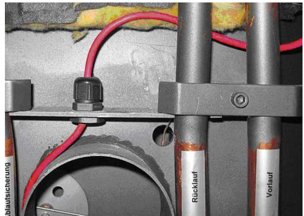
Fig. 25 : décharge de traction du capteur chaudière
